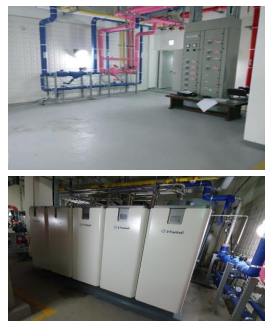
PEMFC 30kW 설치 현황
